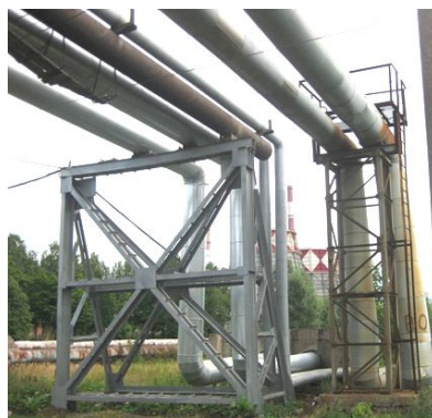
Рис. 1.26. Проведение теплопроводов над дорогой
